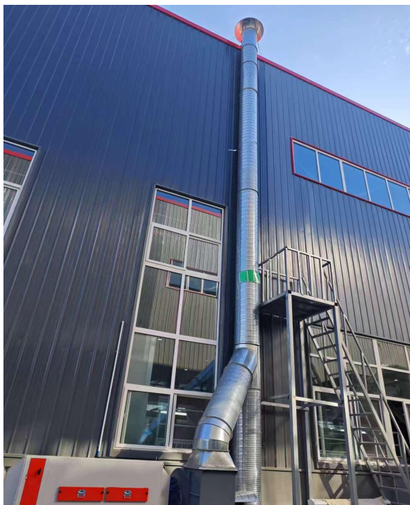
注塑、打胶废气 15 米排气筒 DA001 及监测平台
