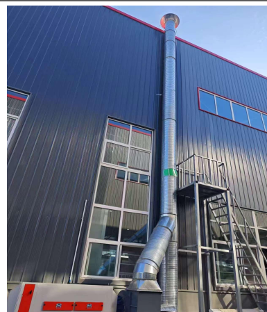
补漆废气 15 米排气筒 DA003 及监测平台
